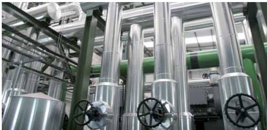
Sistema de climatización centralizada de biomasa. Parque Científico- Tecnológico Geolit en Mengíbar. Jaén.
